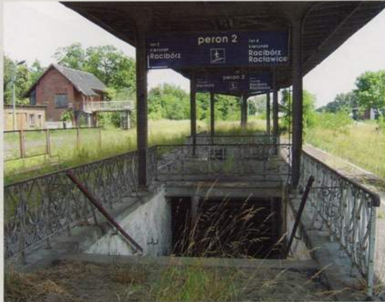
Lipiec 2006 roku, wejście z peronu 2 do tunelu – stacja pogrąży się w destrukcji, ozdobna balustrada przypomina o dawnej świetności... Fot. R. Kozyra
